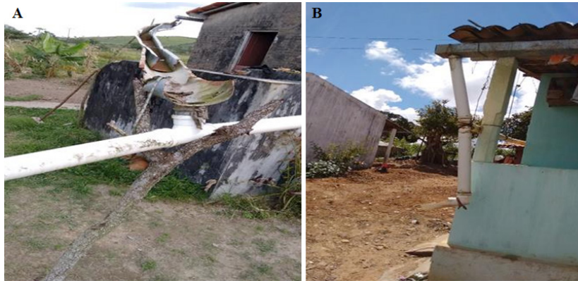
Figura 4 - Problemas estruturais em calhas e tubos condutores.
