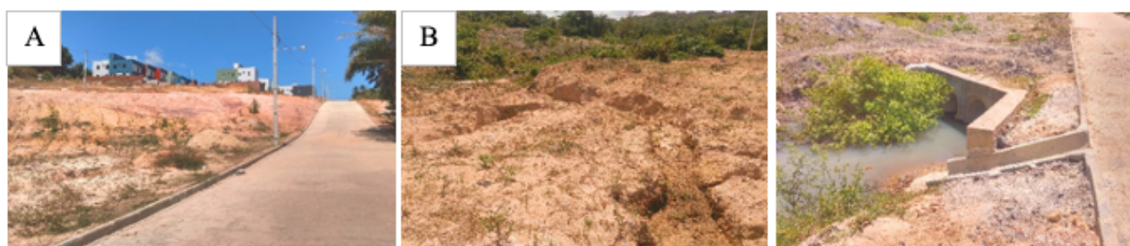
Figura 15. Processo de erosão em loteamento, Muçumagro, Loteamento Jardim Valentina (João Pessoa, PB): (A) Vista de sul para norte do loteamento; (B) Ravinas decorrentes de processo erosivo; (C) Galeria de canalização de curso d'água.
