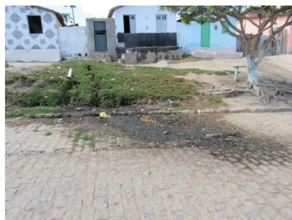
Foto 02. Esgoto das residências na Rua Carlos Cajazeiras. Foto: Thassio Vinícios, 2015.
