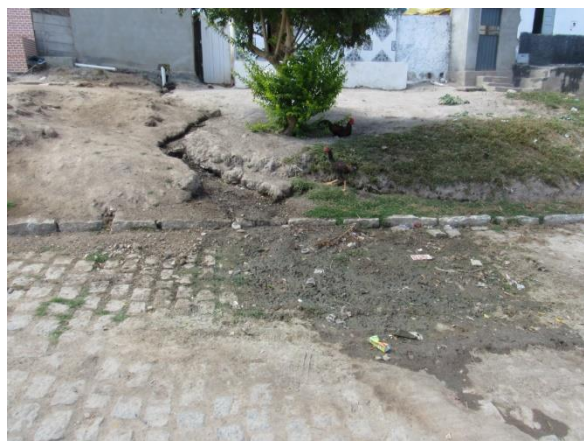
Foto 01. Esgoto das residências na Rua Carlos Cajazeiras. Foto: Thassio Vinícios, 2015.
