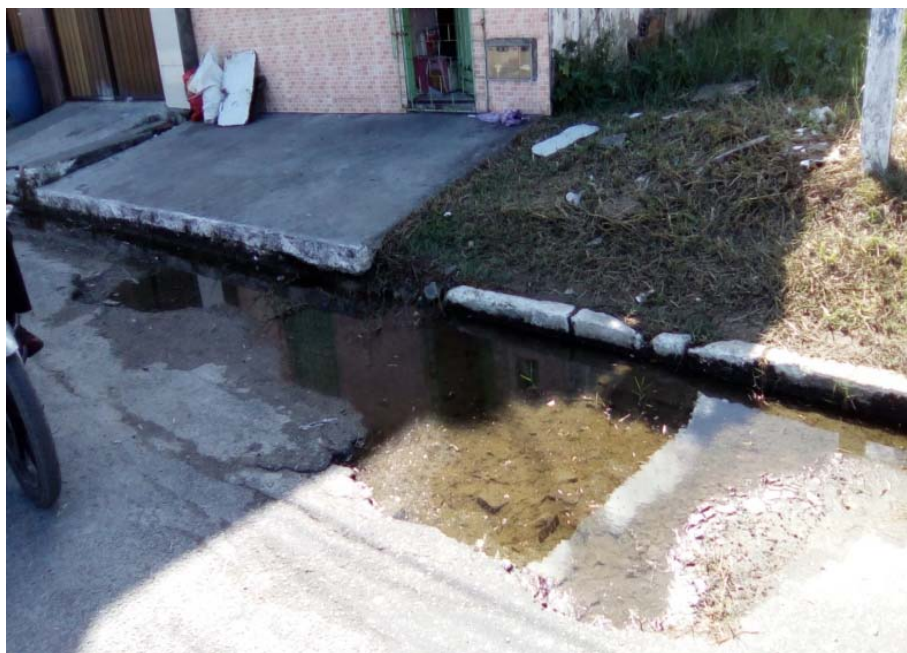
Figura 7. Acúmulo de água no centro de Barra dos Coqueiros/SE.
