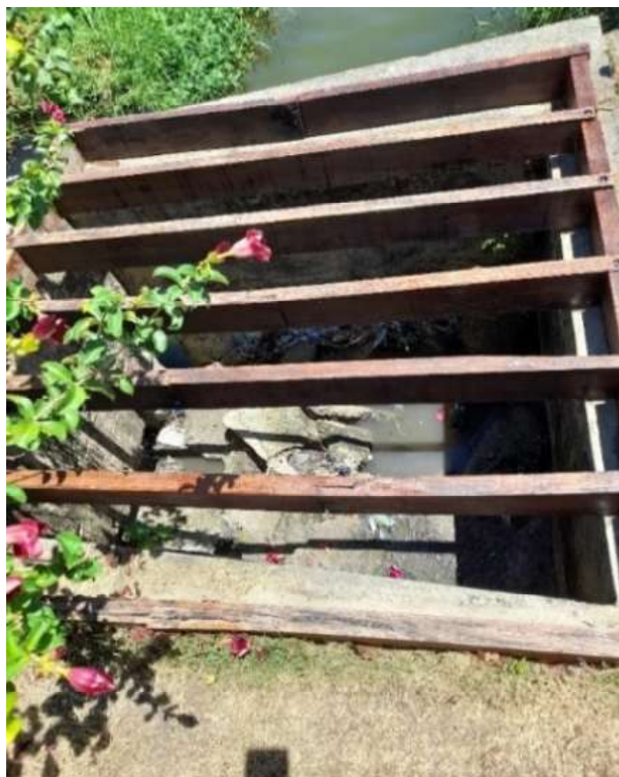
Figura 2. Galeria pluvial com esgoto entrando na Lagoa, no ponto 3.
