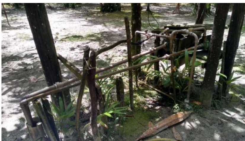
Figura 3. Sistema de abastecimento comunitário na comunidade João Pilatos.
