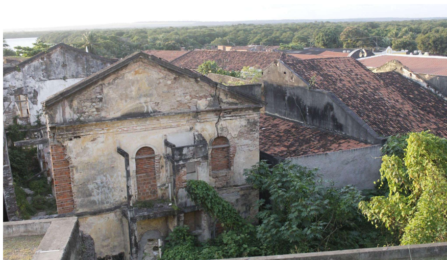
Figura 4. Armazéns e Alfândega do antigo porto do Capim em ruínas no bairro do Varadouro.
