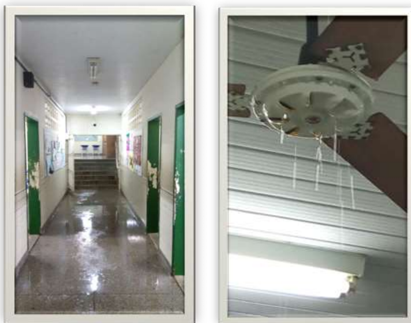
Figura 2: Água descendo pelo corredor/Figura 3: Água descendo pelo ventilador
