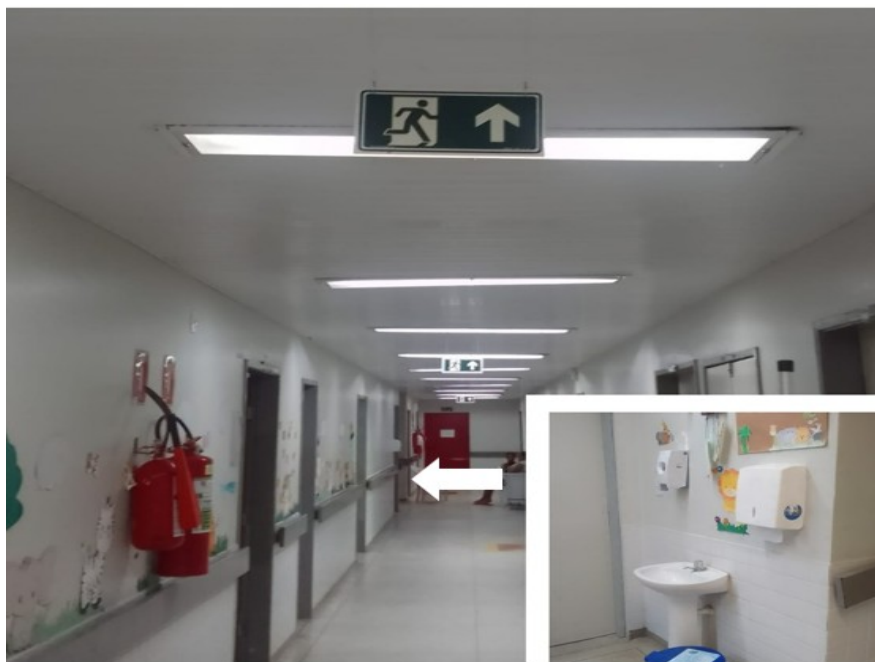
Figura 2- Lavabo para higienização das mãos pelos profissionais de saúde no corredor principal e sinalização da rota de fuga da ala de internação de Pediatria do Hospital Universitário Lauro Wanderley, João Pessoa, PB, 2024
