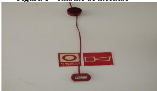
Figura 6 – Alarme de incêndio
