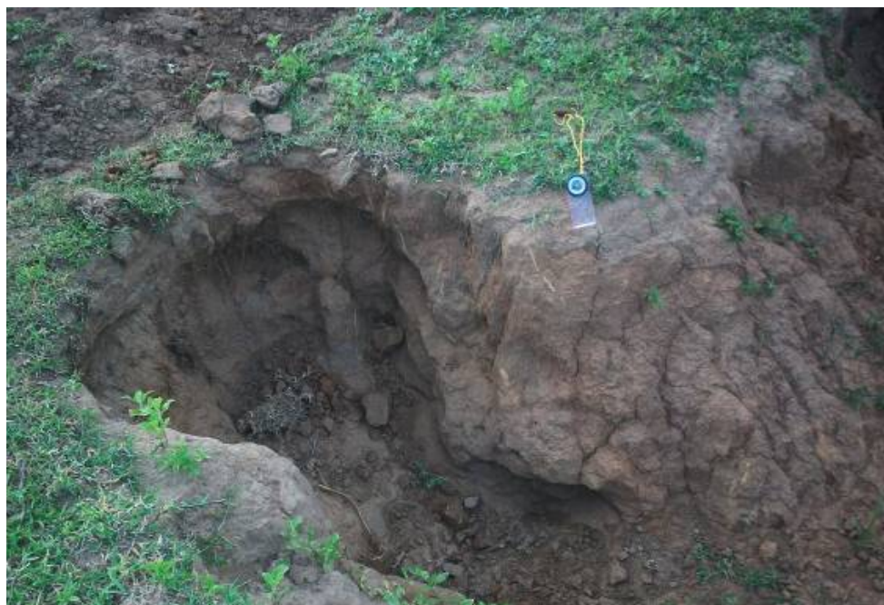
Figura 8 – Ocorrência de processo erosivo em terraço fluvial nas proximidades da entrada do município de Taperoá (PB).
