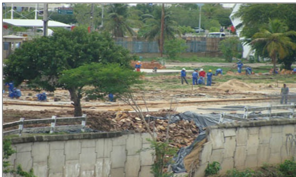
Figura 7. Parque Potycabana com o dique de contenção rompido após chuvas de 2010
