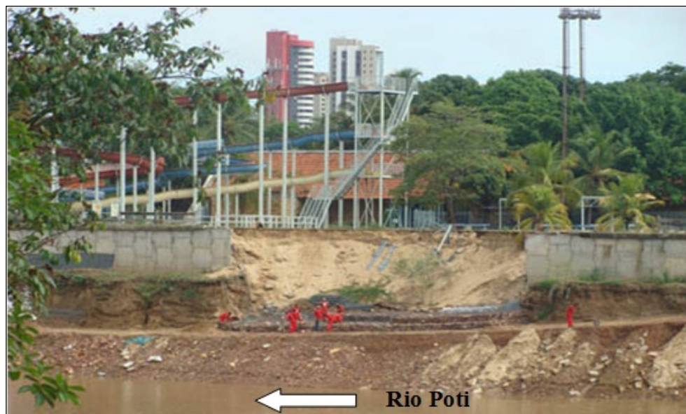
Figura 6. Parque Potycabana com o dique de contenção rompido após chuvas de 2009
