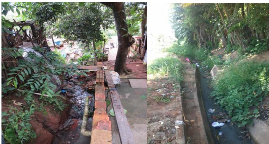
Figura 4. Lançamento de águas servidas (Mutange)
