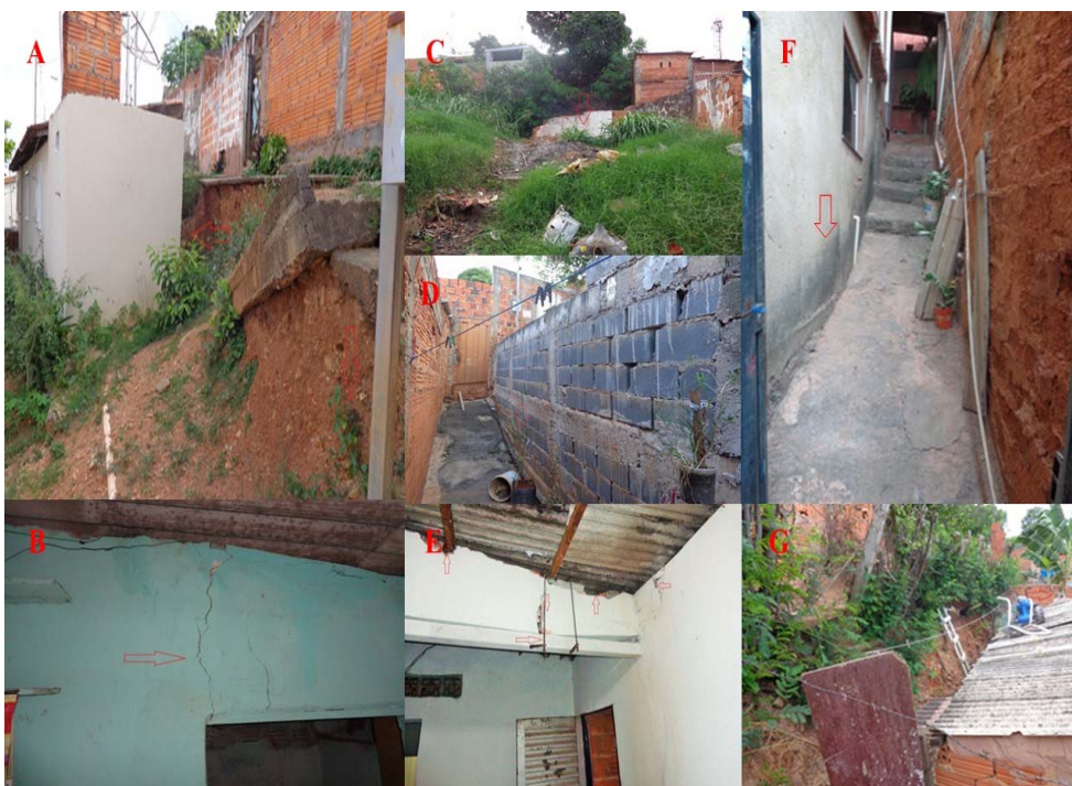
Figura 5. Panorâma do Risco associado a Movimento de Massa na Vila São Francisco de Assis/Montes Claros-MG: A - Setor 1: Habitações construídas sobre área de declive acentuado com deslizamento de solo, edificação a jusante e acima da área de deslizamento. B - Setor 2: Rachaduras na edificação mal alicerçada. C - Setor 3: Queda de muro decorrente de deslizamento. D - Setor 4: Embarrigamento de muro pela pressão da força gravitacional. E - Setor 5: Rachaduras na parede com calha da edificação suspensa por gancho de aço para evitar queda. F - Edificações construídas em área de declive com embarrigamento da parede. G - Edificação próxima a talude de corte, com histórico de deslizamento.
