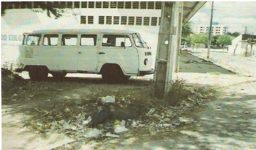
Figura 2. Bueiro entupido de lixo na Comunidade do Prado.
