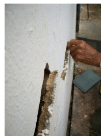
Fig. 2 - Rachadura em parede de uma residência Foto: Arthur Pires Amaral (março de 2011)
