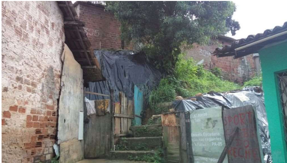
Figura 3 - Contenção da encosta que sofreu processo de deslizamento com lona plástica em pontos sem cobertura vegetal natural - Comunidade Baixa da Colina, bairro Cavaleiro, Jaboatão dos Guararapes
