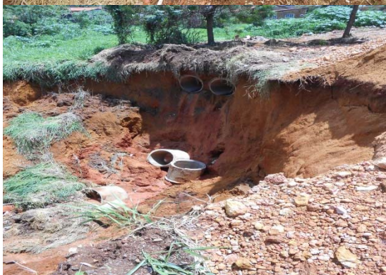
Figura 25: Formação de voçoroca e queda de tubulação pluvial em área do Parque Tamanduá.
