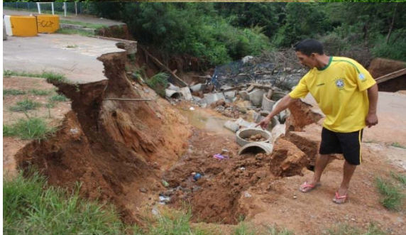
Figura 18: Rompimento de drenagem urbana na vizinhança do parque
