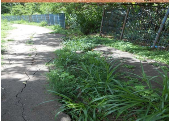
Figura 27: Colapso do solo e fendas em pista de cooper do parque.
