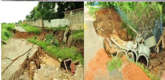
Figura 20: Degradação de ruas que acessam o parque.
