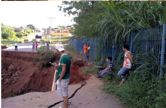
Figura 15: Processos erosivos na área do parque. Fonte: https://guiaecologico.wordpress.com/tag/corrego-tamandua-em-aparecida/
