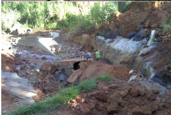
Figura 16: Desmoronamento de rua junto ao parque. Fonte: https://guiaecologico.wordpress.com/tag/corrego-tamandua-em-aparecida/
