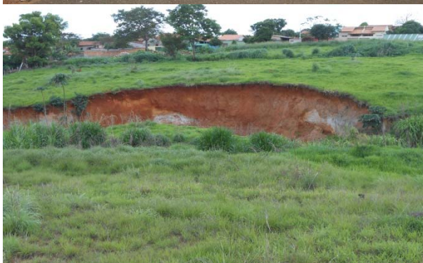
Figura 23: Pressão urbana no entorno do parque e solapamento marginal em córrego.
