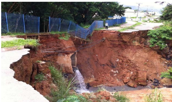
Figura 11: EROSIÃO NO PARQUE TAMANDUÁ / Fonte: http://tamanduafm.wordpress.com/2012/01/14/parque-ecologico-do-setor-garavelo-um-descaso/
