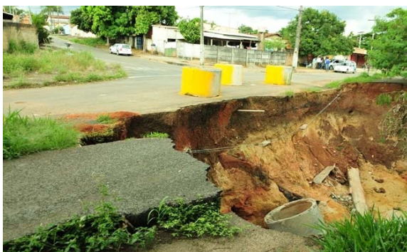
Figura 17: Desmoronamentos de ruas na vizinhança do parque.
