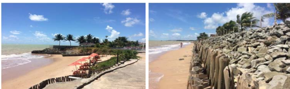
Figura 9. Praia Ponta do Seixas, litoral sul de João Pessoa PB; (PO=10). Localização: 07° 09'22" LS; 34° 47'36" LO; Indicadores de erosão, III, IV, V, VI, VII, VIII, X, XI. Destaque para a destruição de estruturas artificiais para proteção costeira. Data da Foto: 09 de outubro de 2017.
