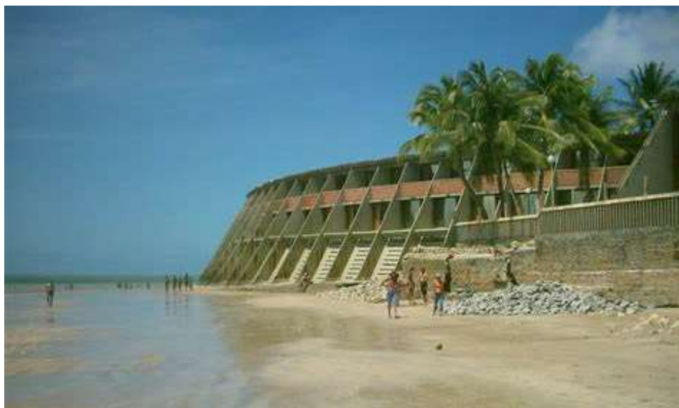
Figura 4. Muro da área de serviço do Hotel Tambaú sendo destruído pela abrasão marinha, a sotavento do hotel.
