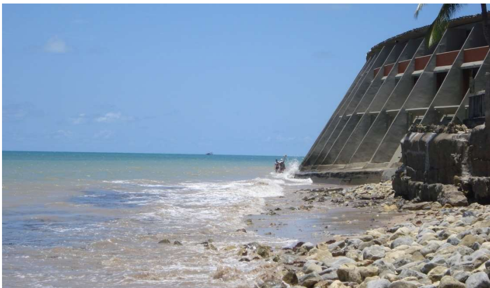
Figura 8. Na preamar, as ondas solapando a base do Hotel Tambaú e do muro da área de serviço do hotel
